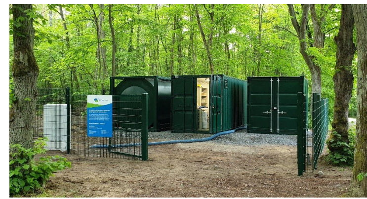
Wassertank, Umkehrosmoseanlage und Pumpe
