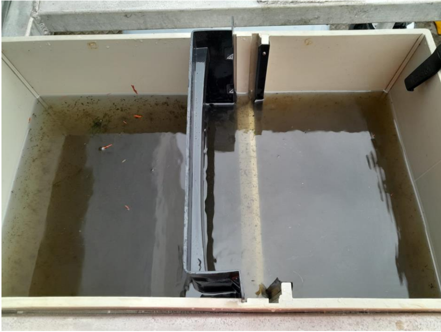
Abb. 7: Während der Reinigung aufgefangenes Wasser durch den abgelösten Bewuchs bräunlich verfärbt.
