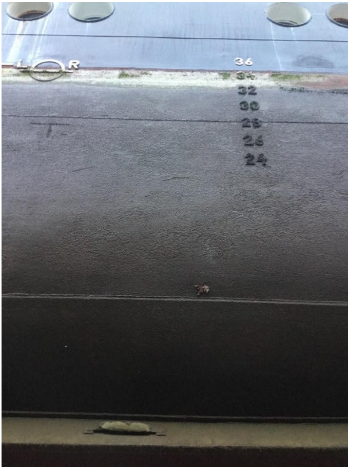
Abb. 5: Backbord Rumpf der "WEGA", Position mittschiffs, an der im Juli 2023 unterhalb der Wasserlinie gereinigt worden war
