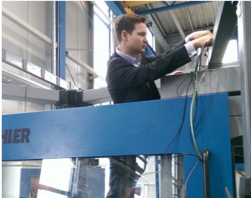
Abbildung 15: Installation der Implementierungen
