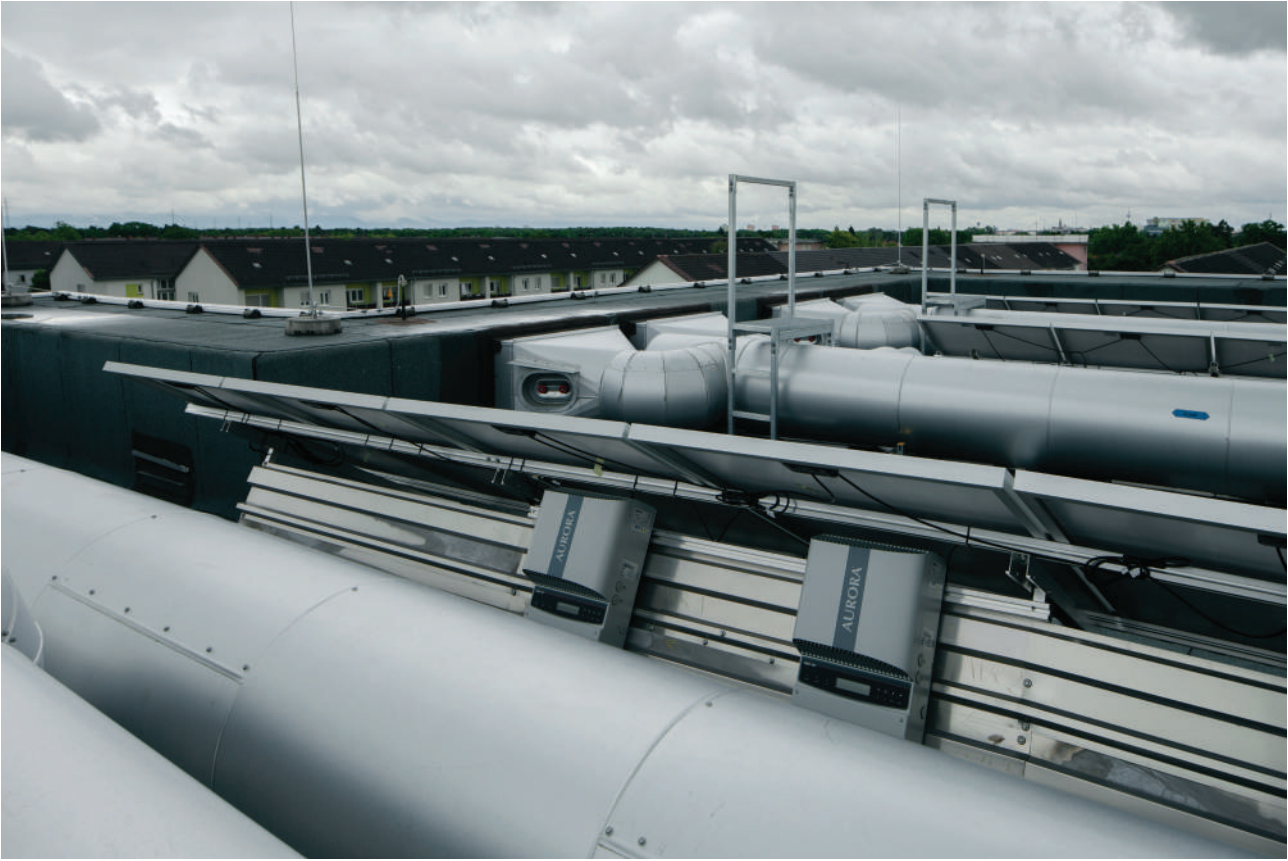
Abb. 23:Foto der Luftverteilsystemes auf dem Dach
