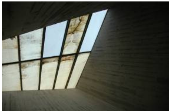
Abb. 29: Verbrauchte Dachverglasung, z. T. blind kein Sicherheitsglas
