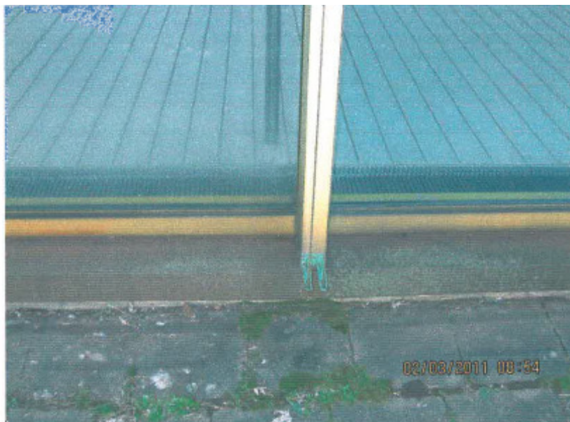
Abb. 56: Geländeanschluss des Hallenbades auf der Südseite, hohe Wärmeverluste an das Erdreich, die (belüftete) Blechabdeckung verdeckt die Temperatur der Mauer, auch hohe Temperaturen am unteren horizontalen Rahmenprofil der Verglasung, das innen besonders warm ist (nahe an Konvektoren). [Quelle 4: Protherm, Dr. Arnim Schwab - Bericht zur Untersuchung des Schulzentrums Nägelsee mit Infrarot-Thermografie]
