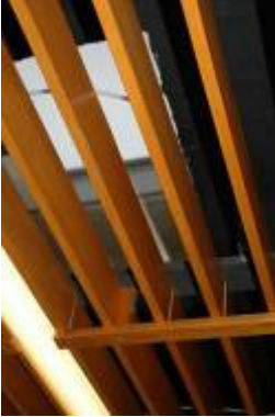
Abb. 25: Durch abgehängte Decke verschattete Lichtkuppel Kunstlicht trotz Lichtkuppel
