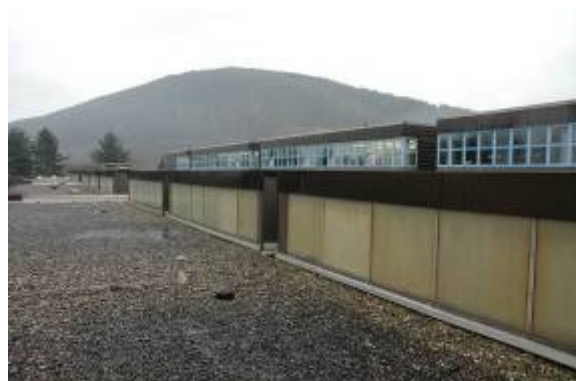
Abb. 27: Fensterfronten-Verglasung: im Zwischenraum veralgelt
