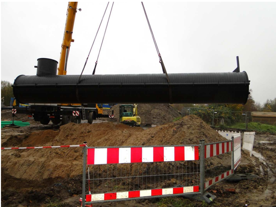
Neue Regenwasserzisterne mit 23.000 l Speichervolumen
