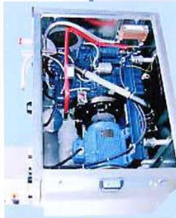
BHKW zur Strom/Wärme-Erzeugung. Leistung 49,089 kW elektrisch/thermisch. Ausgelegt auf 6.000 Betriebsstunden/Jahr. Wärmehöchstleistung aus dem Abgas zusätzlich 16 kW
