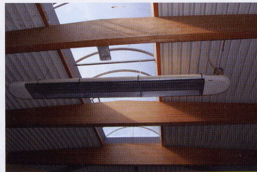
Eine Infrarotheizung sorgt im Elefantenhaus für wohlige Wärme.
