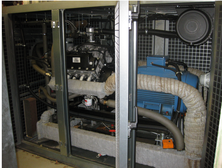
Abbildung 13: Blockheizkraftwerk im Zoo Osnabrück
