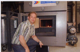
Im Herbst wird die neue Hackschnitzelanlage ans Netz gehen.
