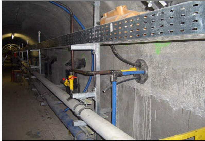
Innenansicht ISK mit Mehrsparten Hausdurchführung Telekom und Kabelfernsehen sowie Internet noch nicht montiert, Brauchwasser vorgerüstet.
