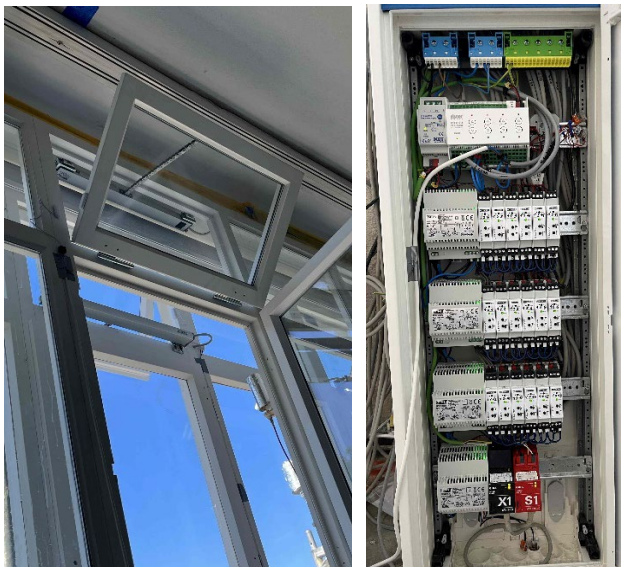
Kettenmotoren und komplexes Steuerungssystem
