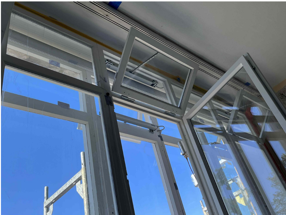
Fassadenklappen mit Kettenmotoren sowie Sonnenschutzrollo oben im Kastenfenster
