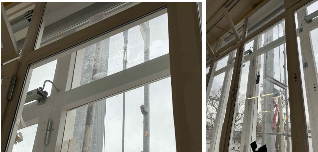
Kondensatbildung unter Extrembedingungen von 55% Raumluftfeuchte im Winter
