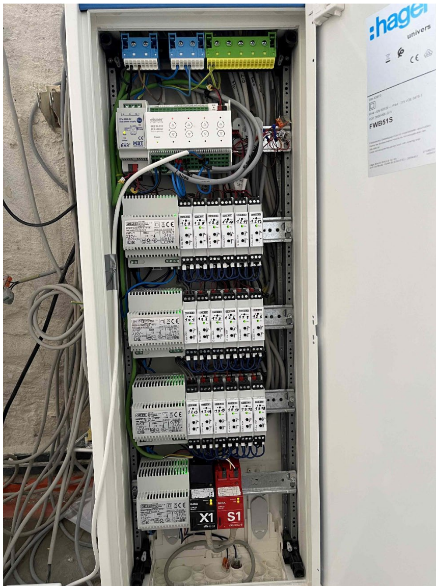
Regelungskasten mit 3 x 6 Aktoren für die Fassadenklappen und 3 Aktoren für die Sonnenschutzsteuerung, sowie der Logik S1 unten, alle mit Netzgeräte
